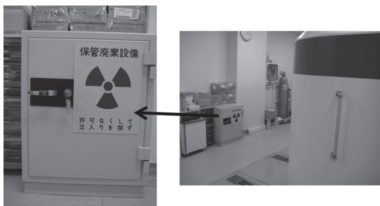
Fig. 8 自己遮蔽型サイクロトロン室内に設備を設置した例
